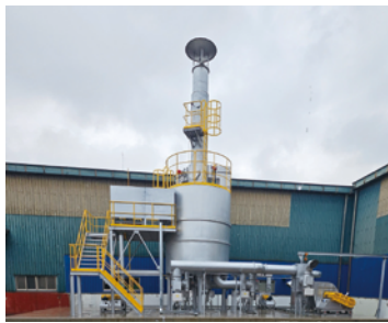
RTO 설비(세아제강 포항공장)
