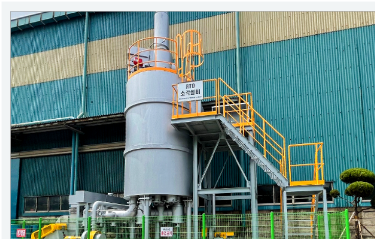
포항공장 RTO 설비
